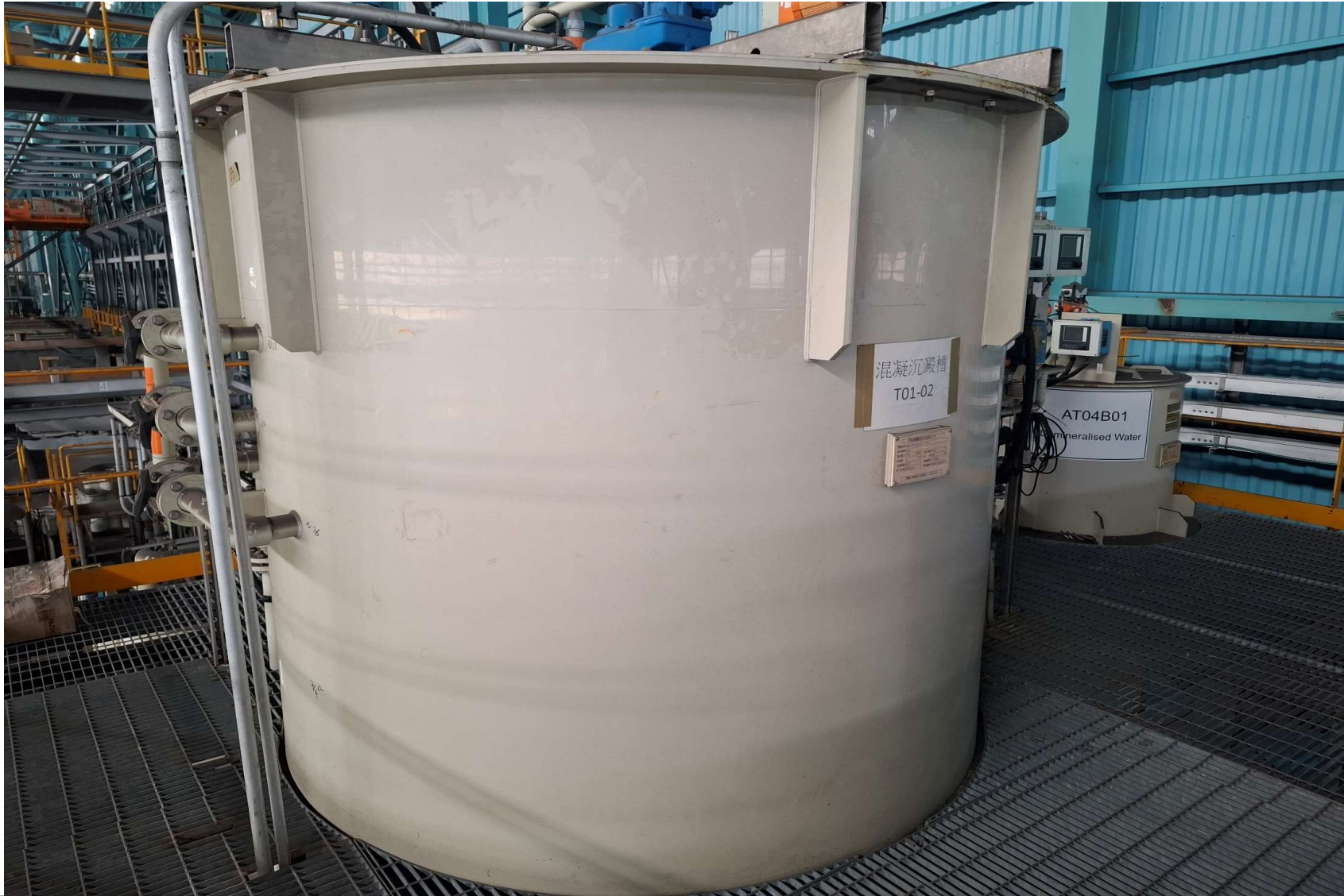
AT02-B05，材質PP，386KG，NEUTRALISATION，二樓
