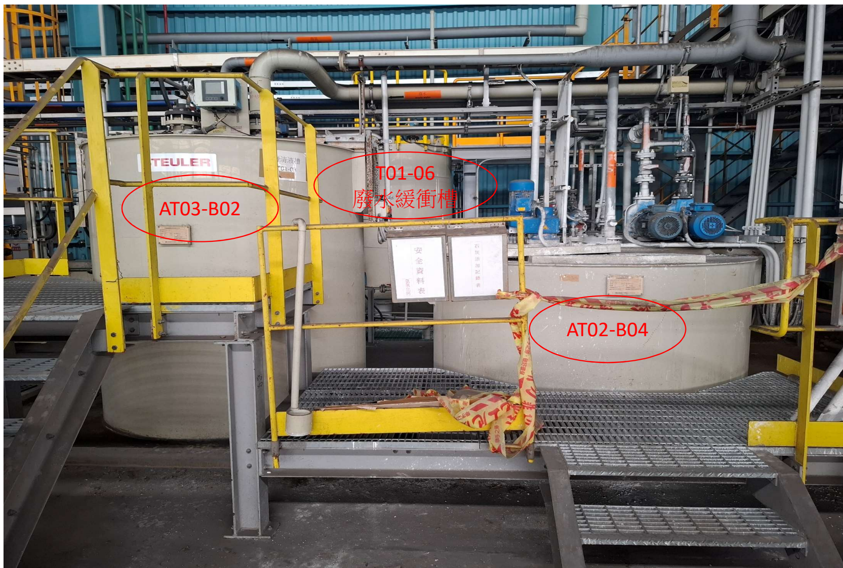
AT03-B02，材質PP，FILTRATE，377KG。AT02-B04，材質PP，LIME MILK，389KG。T01-06，材質PP，廢水緩衝槽，345KG。
