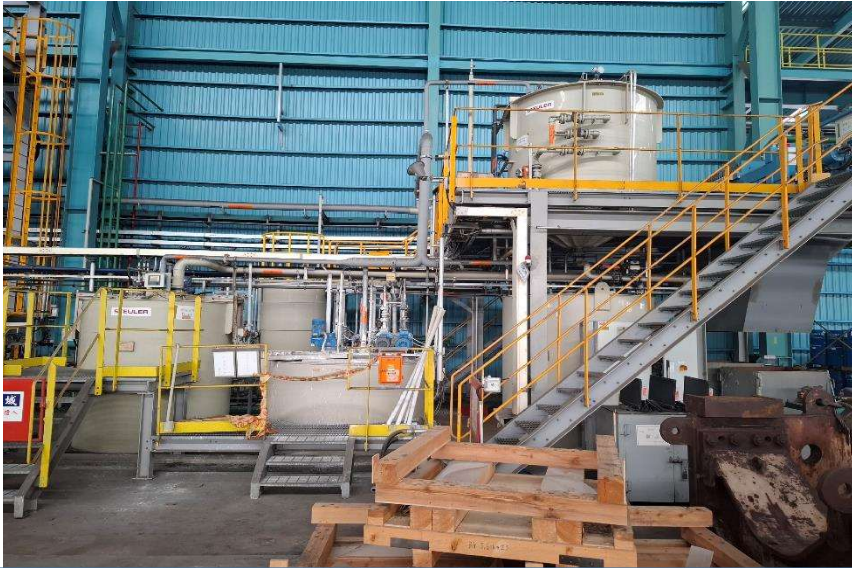
廢水處理設備，總共11個分項設備，其中9項桶槽材質為PP，2項設備材質為鐵
