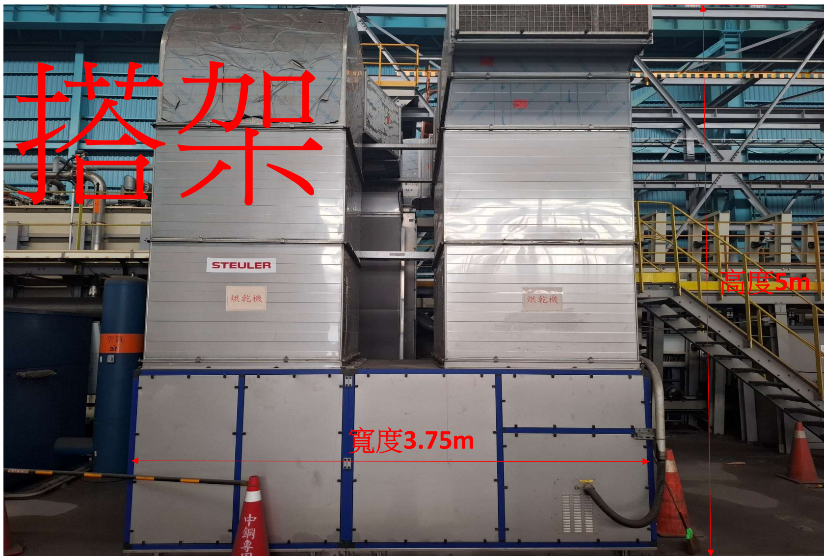
烘乾機組，保留原因:拆除須搭架
