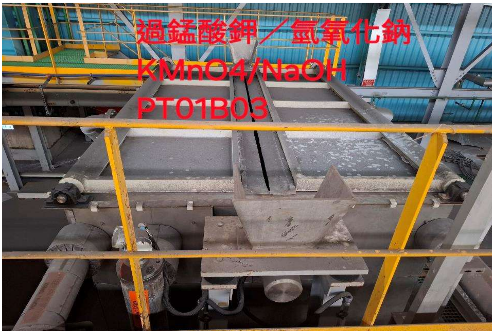
批次式盤元酸洗設備，西1，過錳酸鉀槽，PT01B03，材質白鐵，2966KG
